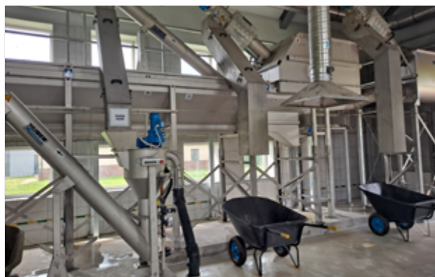
Urządzenia do mechanicznego podczyszczania ścieków
