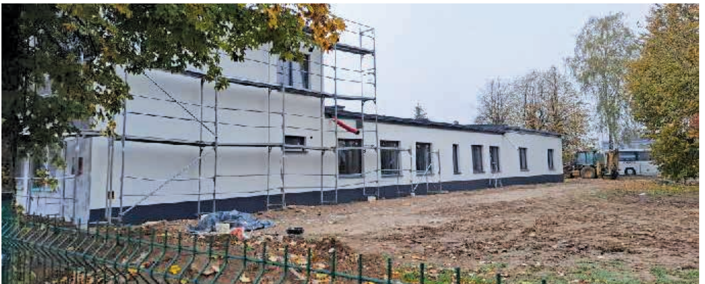
Budynek administracyjno-garażowy Przedsiębiorstwa Usług Komunalnych w Kolnie Sp. z o. o. – zdjęcia przed oraz w trakcie termomodernizacji.
